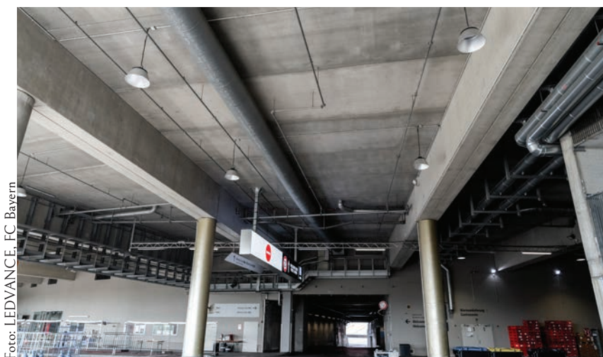
Accentul nu este pus doar pe produse, ci și pe expertiza de proiect în toate etapele proiectului, de la proiectare și implementare până la performanța pe termen lung. Un exemplu este noul sistem de iluminat al parării, modernizat prin implementarea tehnologiei LED, în contextul eliminării surselor de iluminat fluorescente.
