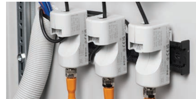
Măsurarea curentului cu ESS 076 într-o rețea electrică trifazată
